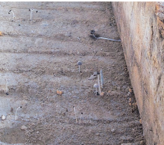
Bild 1 | Befall durch Tintlinge an einer frei gelegten Holzbalkendecke
