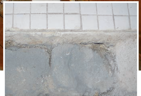
Bild 7 | Auch unter dem Estrich hat sich das graue Strangmycel des Echten Hausschwammes über den Raum ausgebreitet.
